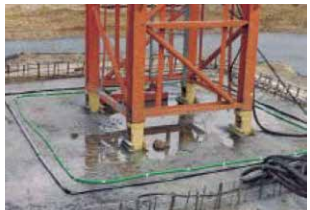
Das Bild zeigt einen stationären Kran. Auf der Sauberkeitsschicht ist eine Sicherheitsfuge eingebaut. Die Bodenplatte wird bis kurz vor den Kran betoniert. Wird die Wandschalung abgestellt, tritt zwischen Sauberkeitsschicht und Bodenplatte kein Wasser mehr aus.
