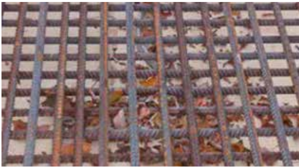
Eingetragenes Laub unbedingt vor der Betonage entfernen
