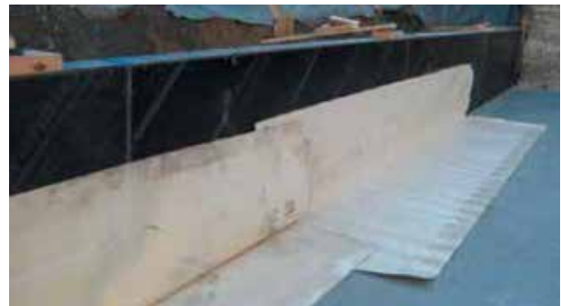
Materialverwerfungen in der Aufkantung durch zu starkes Umformen (li) und korrekt umgeformte Dichtungsbahn (re)
