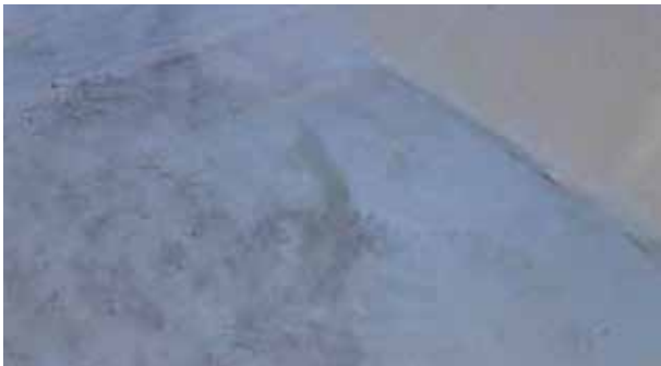
Verschmutzungen, wie hier Zementschlämpen, müssen sofort entfernt werden
