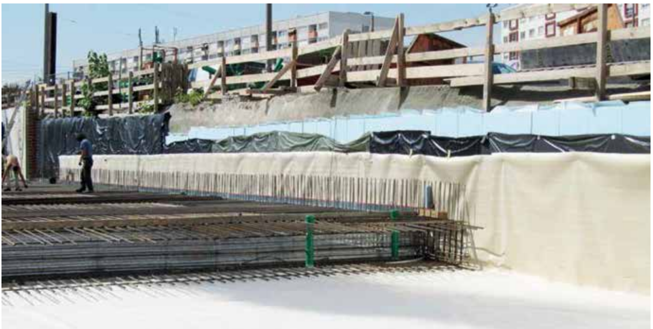
Beispiel einer Boden-Wand-Fuge ohne Ausbildung eines Bodenüberstandes, in diesem Fall mit einer Tricoflex® Abklebung
