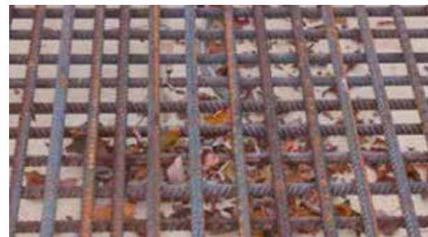
Eingetragenes Laub unbedingt vor der Betonage entfernen
